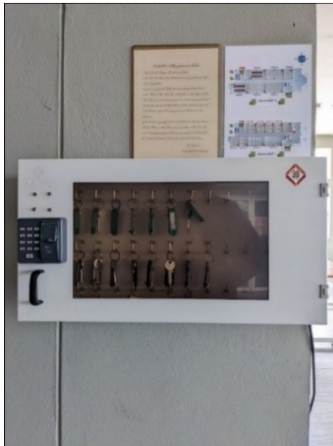
ภาพที่ 4 ภาพการติดตั้งตู้เก็บลูกกุญแจระบบสแกนลายนิ้วมือ
