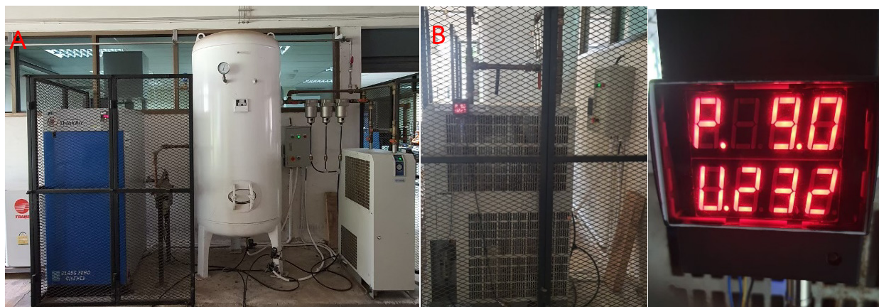
ภาพที่ 5 ระบบเครื่องทำลมแห้ง (A) และตำแหน่งที่ติดตั้งระบบเส้นระวางแรงดันลมแห้งและสถานะไฟฟ้าของเครื่องทำลมแห้งสำหรับเครื่องมือวิทยาศาสตร์ (B)
